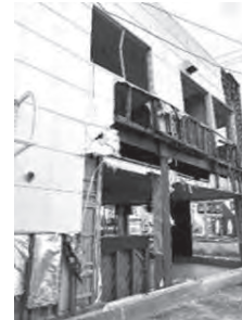
図 3-3 C：著しい劣化状態のサイディング
