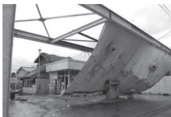
図 2-3 C：著しい劣化状態の鋼板製屋根
