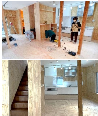
床面にヤスリをかける学生ら(上) 柱や階段などを残して改修(下)
