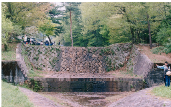
不動川砂防歴史公園内の砂防施設
